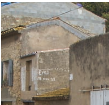
Repère de crue ancien
